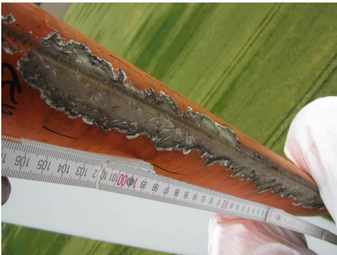
Abbildung 5: Vorderkantenerosion an einem Windradflügel. Bild: MB Bladeservice Einbeck
